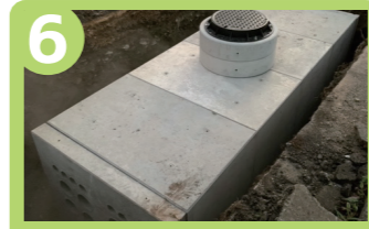
6 自営線接続トラフ
