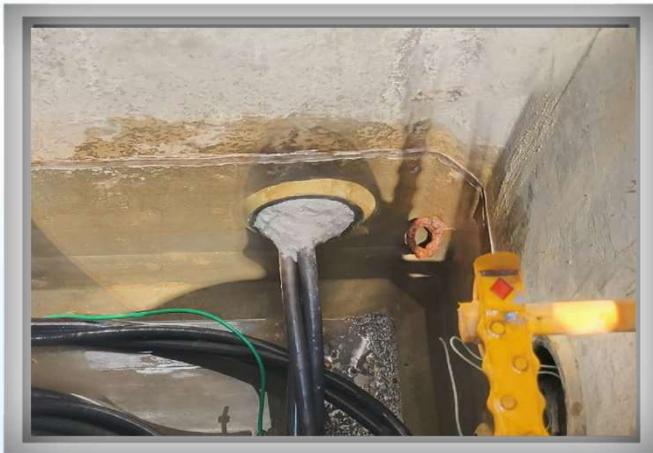
電力設備/ハンドホール
