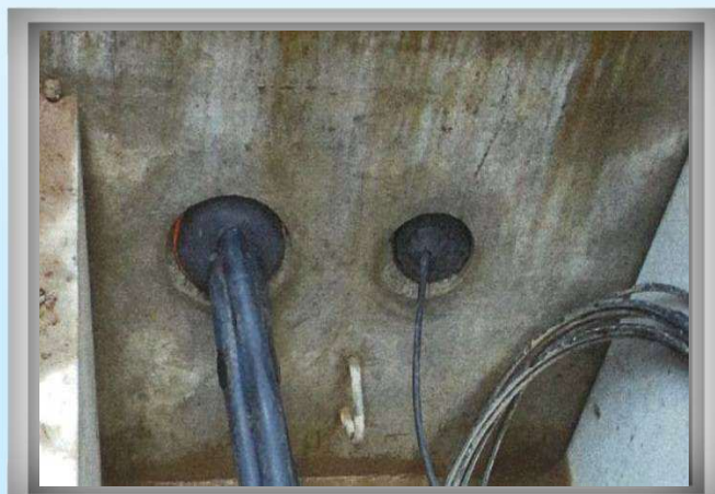
再生可能エネルギー(自営線)/ケーブル接続BOX
