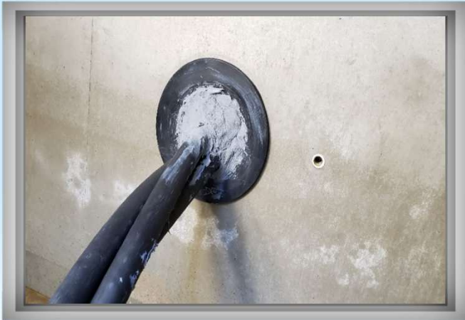
再生可能エネルギー(自営線)/ハンドホール
